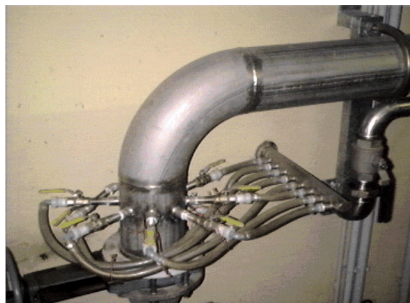
Abb.: Dosierkranz und Verteiler mit 8 Dosierdüsen Typ K41, in einer Schlammleitung installiert
